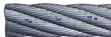
fils cassés au niveau des "parures"
